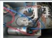
2 จดบันทึกสายไฟที่ต่ออยู่กับคาปาซิเตอร์ก่อนทำการรื้อ
