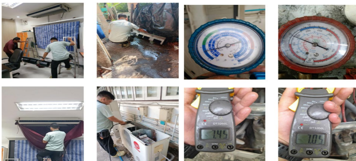
ภาพที่ 1 การทำความสะอาดเครื่องปรับอากาศ ตรวจสอบการทำงานของระบบน้ำยา และระบบไฟฟ้า
